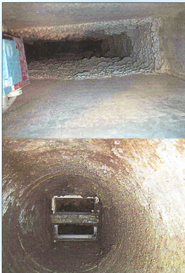
Innenansicht einer Lüftungsleitung, welche nicht überprüft und gewartet wurde.
